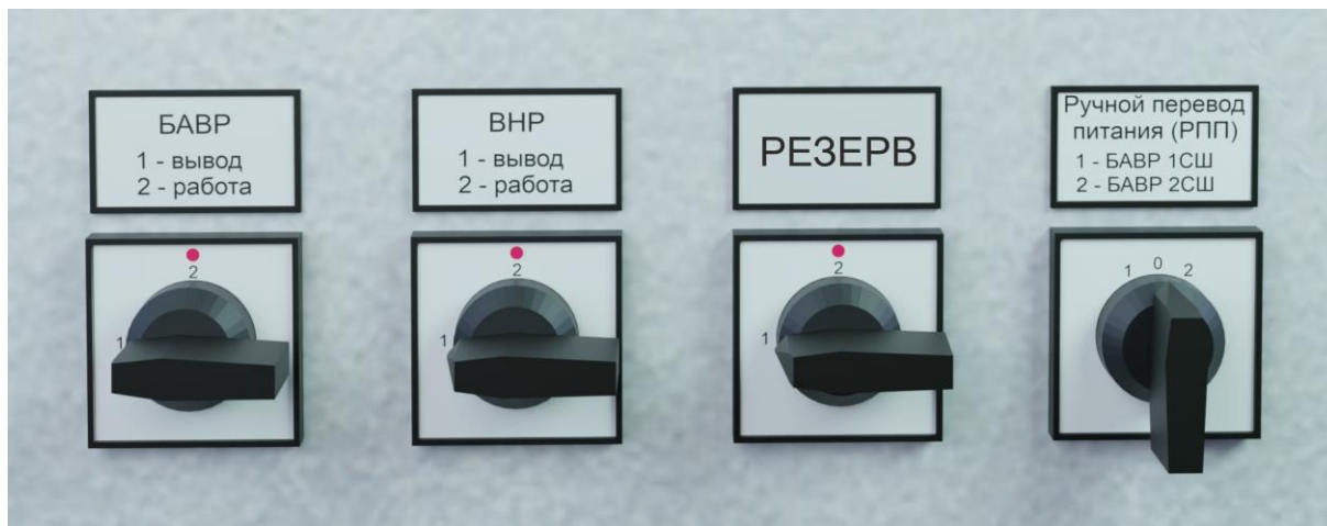
Рис. АПС. 8. Ключи управления шкафа БАВР
